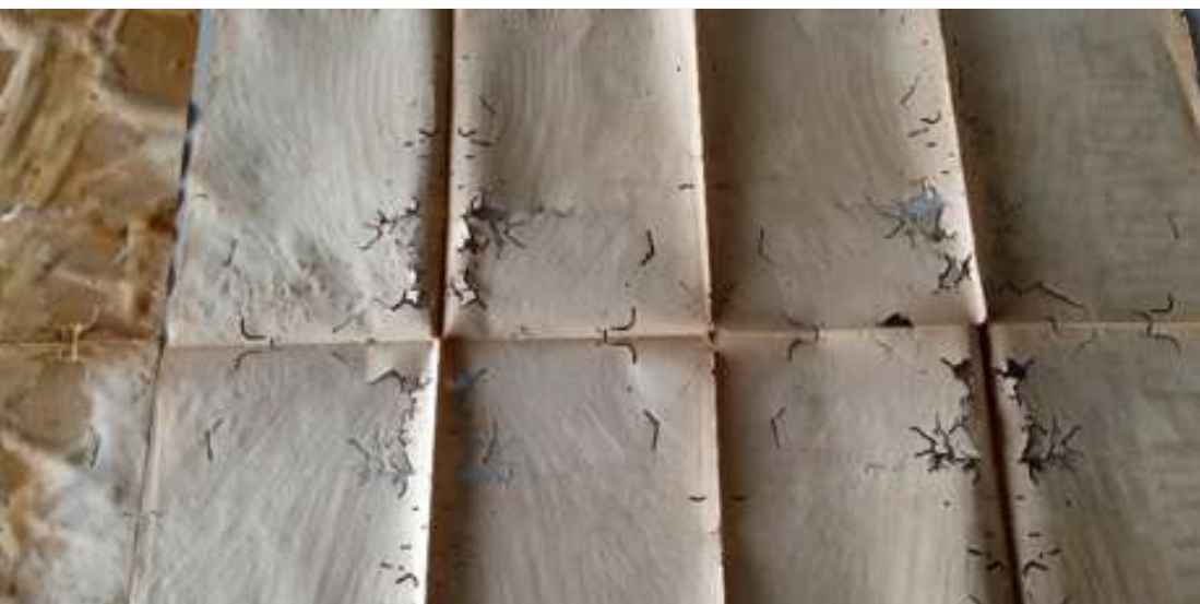
Dobleces, galerías, deformación de soporte
